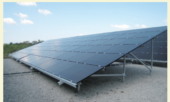
自社製の架台・基礎を使用した創電の太陽光発電所
